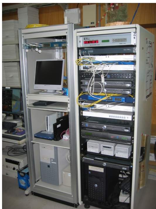
防災研究所附属地震予知研究センター上宝観測所のネットワーク機器類 (後ろ側天井近くに見えるのが光ケーブル成端箱，左側のラックの中段に KUINS3 接続用の ルータ等が見え，右側のラックには地震波形データの 解析用の計算機類が収納されています)
