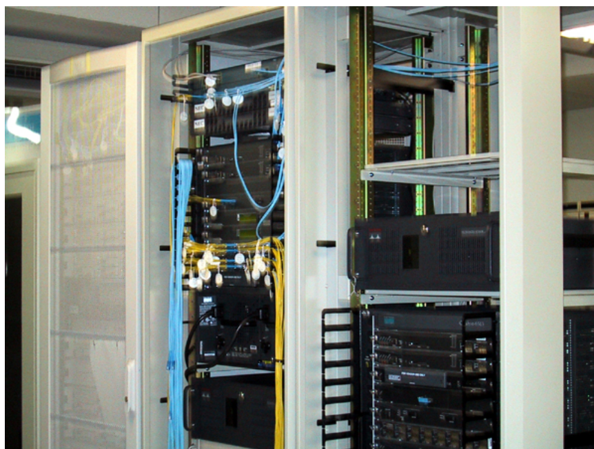
安全なギガビットネットワークシステム (KUINS-III) 導入機器 (大型計算機センター)
