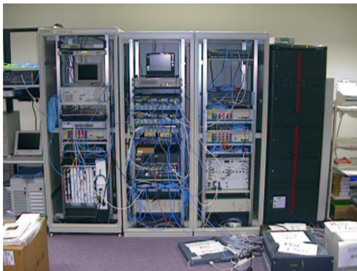
図 4: 構築中の館内ネットワーク (計算機室)
