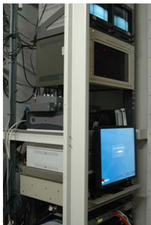
図 1.20: EPS 内のラック
